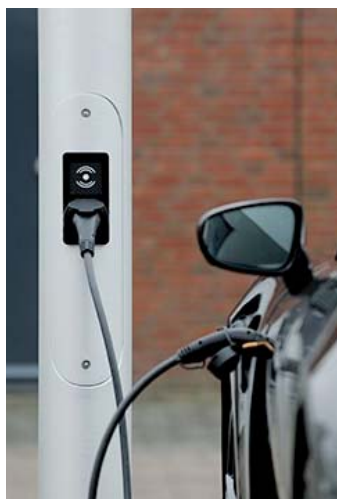
Een nieuwe en speciaal hiervoor ontworpen lichtmast
