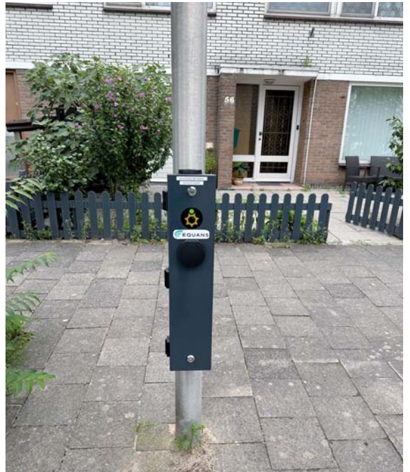
Een omgebouwde bestaande lantaarnpaal in Ondiep
